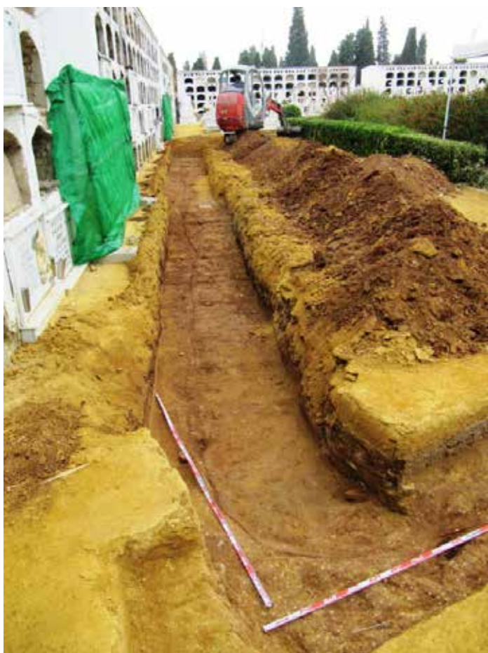
Imágenes del desarrollo de la intervención. Arriba, proceso de excavación manual de la Cuadrícula 1. Abajo, trabajos desarrollados con pala retroexcavadora para localizar el límite oriental de la fosa.
