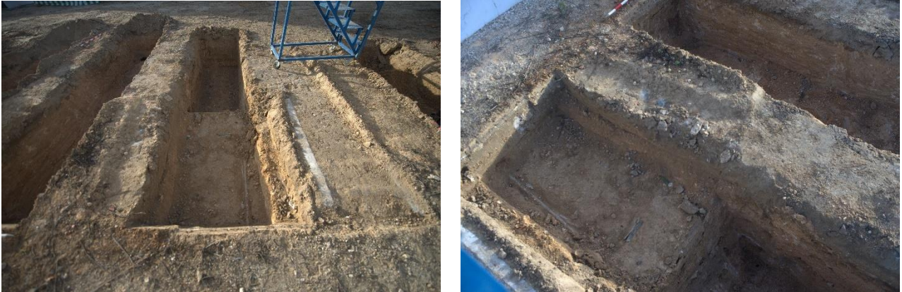
Cata 3 y cata 4 en sondeo 1, con detalle de la cata 4 en el que observamos el ataúd de plomo resaltado (rojo).
