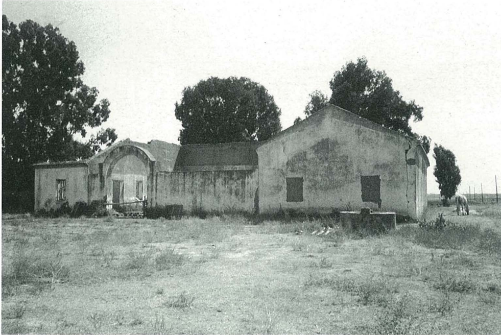
Estado actual de uno de los edificios que albergaron a las colonias penitenciarias militarizadas en las inmediaciones del aeropuerto de Sevilla.
