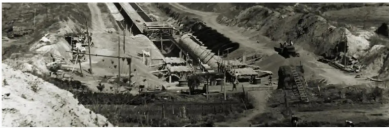
Las obras del canal del Bajo Guadalquivir, en Sevilla, construido con trabajos forzados. RMHSA-CGT.A
